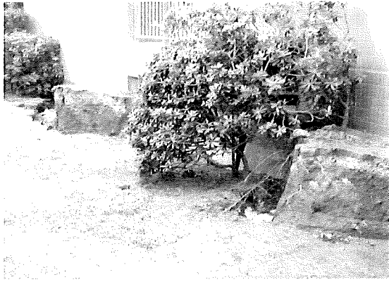
地盤沈下した敷地
